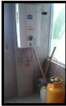
Fig. 13 Nodo sensor 1 en bodega
